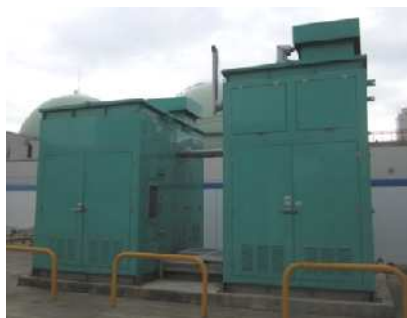
水素製造装置
