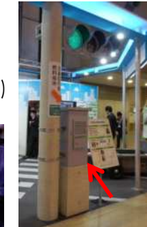
交通信号用燃料電池 出典: 日本製鋼所
