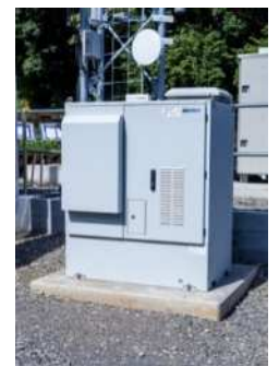
携帯電話基地局の 非常用燃料電池 出典: NTTドコモ
