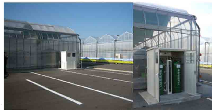
植物工場 CO 2 受入・供給設備
