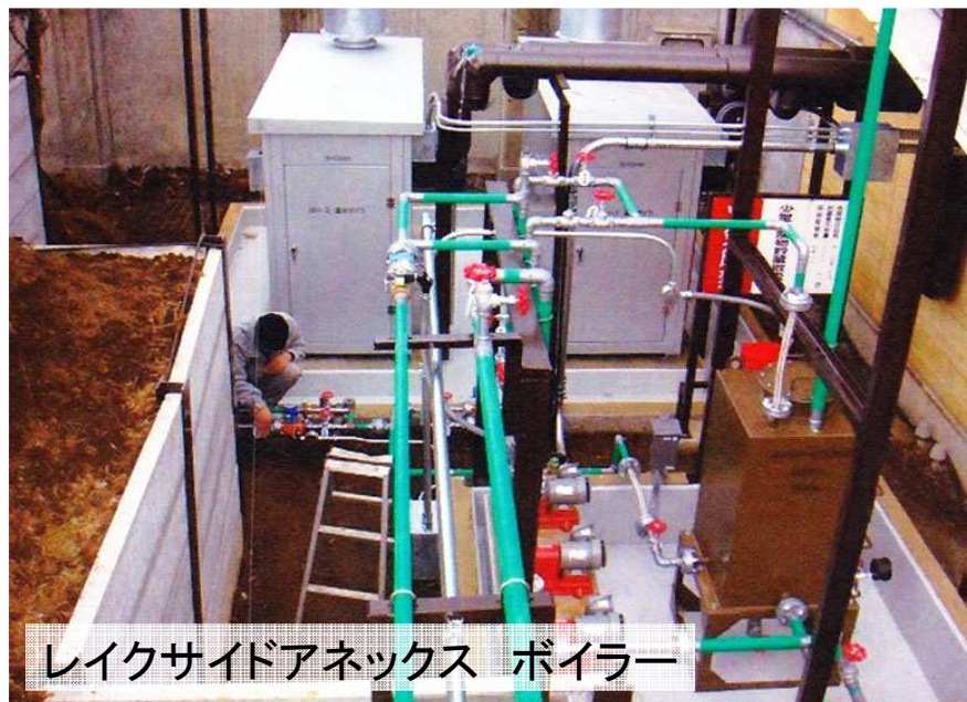
箱根園ゴルフ場 ボイラー
