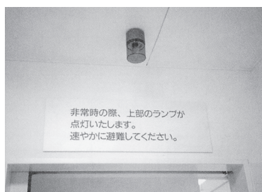
写真2 点滅ランプ付非常口表示灯
