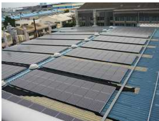
太陽光発電設備（工場屋根）
