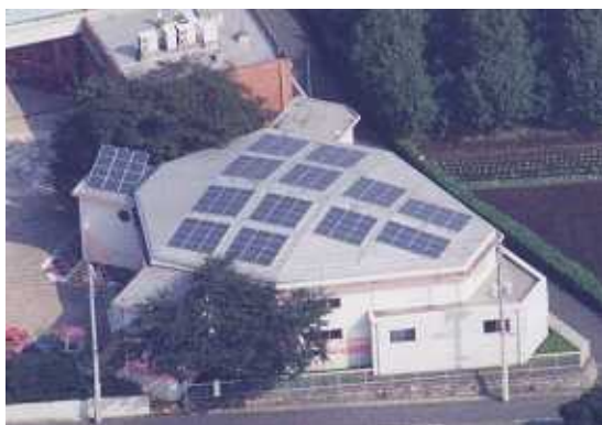
太陽光発電設備(体育館)
