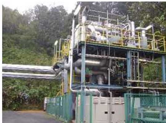
鶏糞ガス化発電システム
