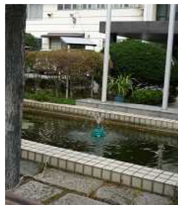
池付近に設置された小型太陽光発電と池の噴水
