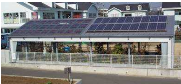
太陽光発電設備
