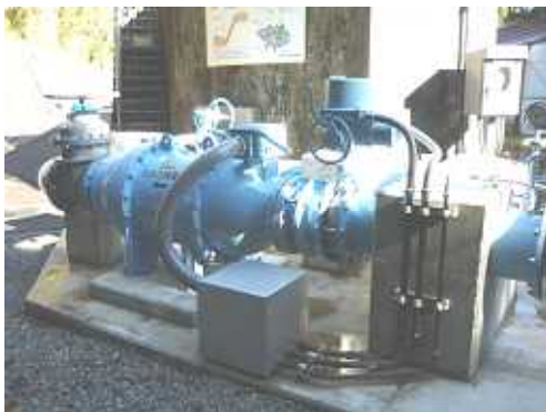
ミニ水力発電設備
