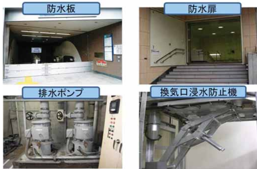
対象となる浸水防止用設備
