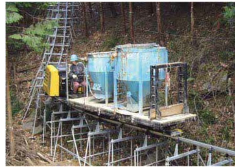
資機材運搬用モノレール
