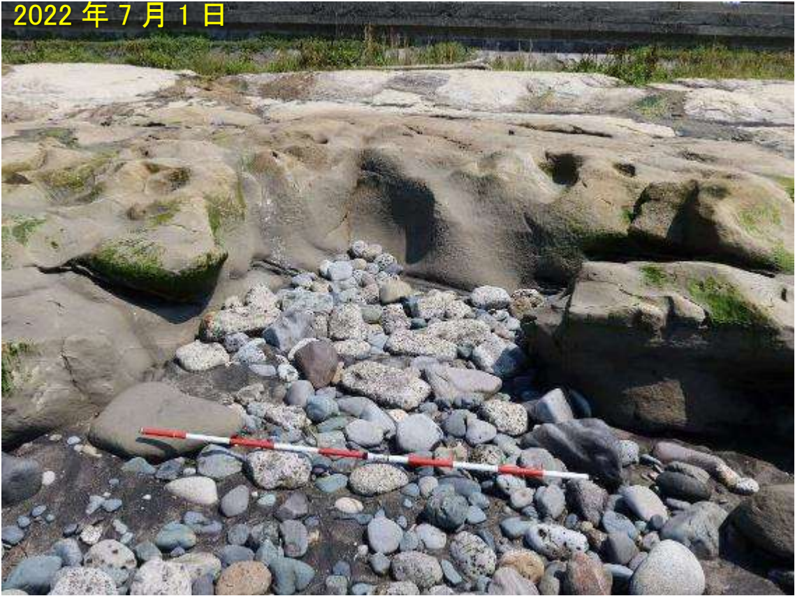
写真-13 大量に堆積した円礫との衝突により侵食が進む軟岩
