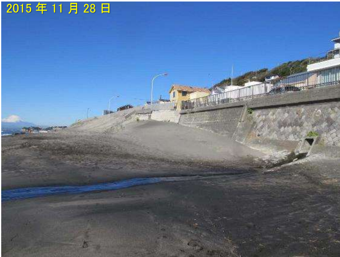
写真-14b 写真-14aと同じ場所の2015年11月28日の状況 排水管の先には砂浜が広がっており、また排水管の西側直近には小高い砂丘が残されていた。
