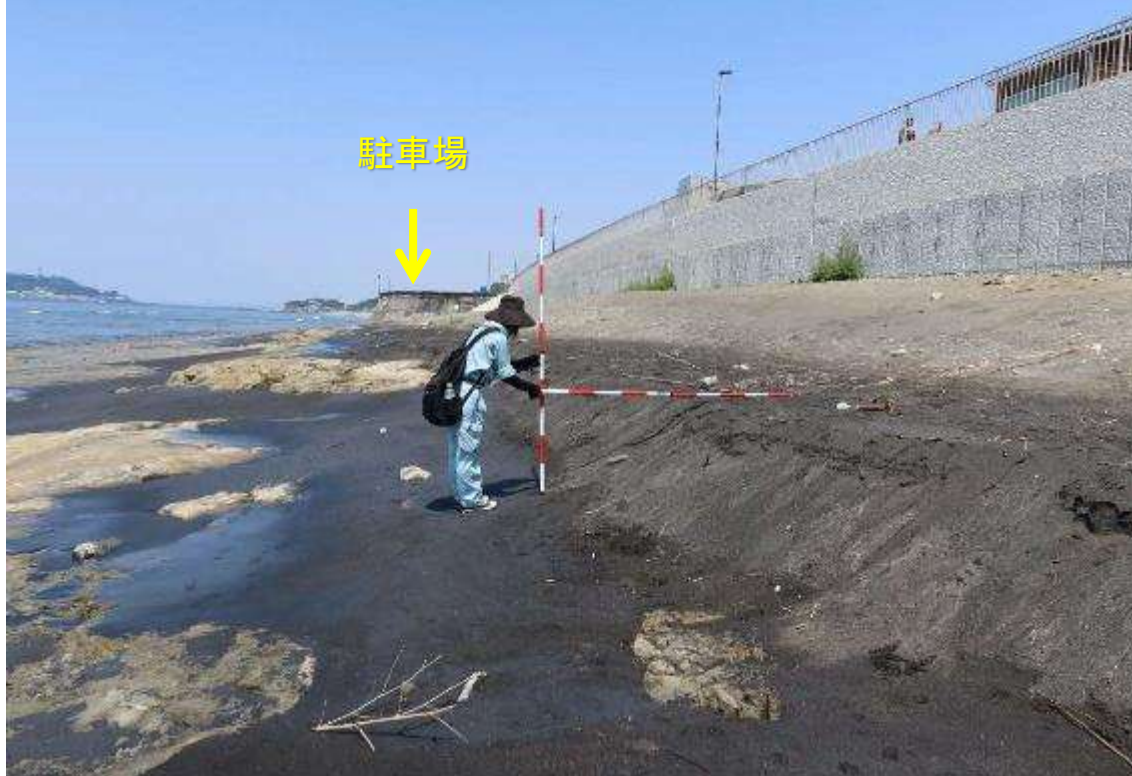
写真-15a 修復された護岸と整地された護岸基部の砂浜で進む侵食 浜崖の比高は0.7 mである.
