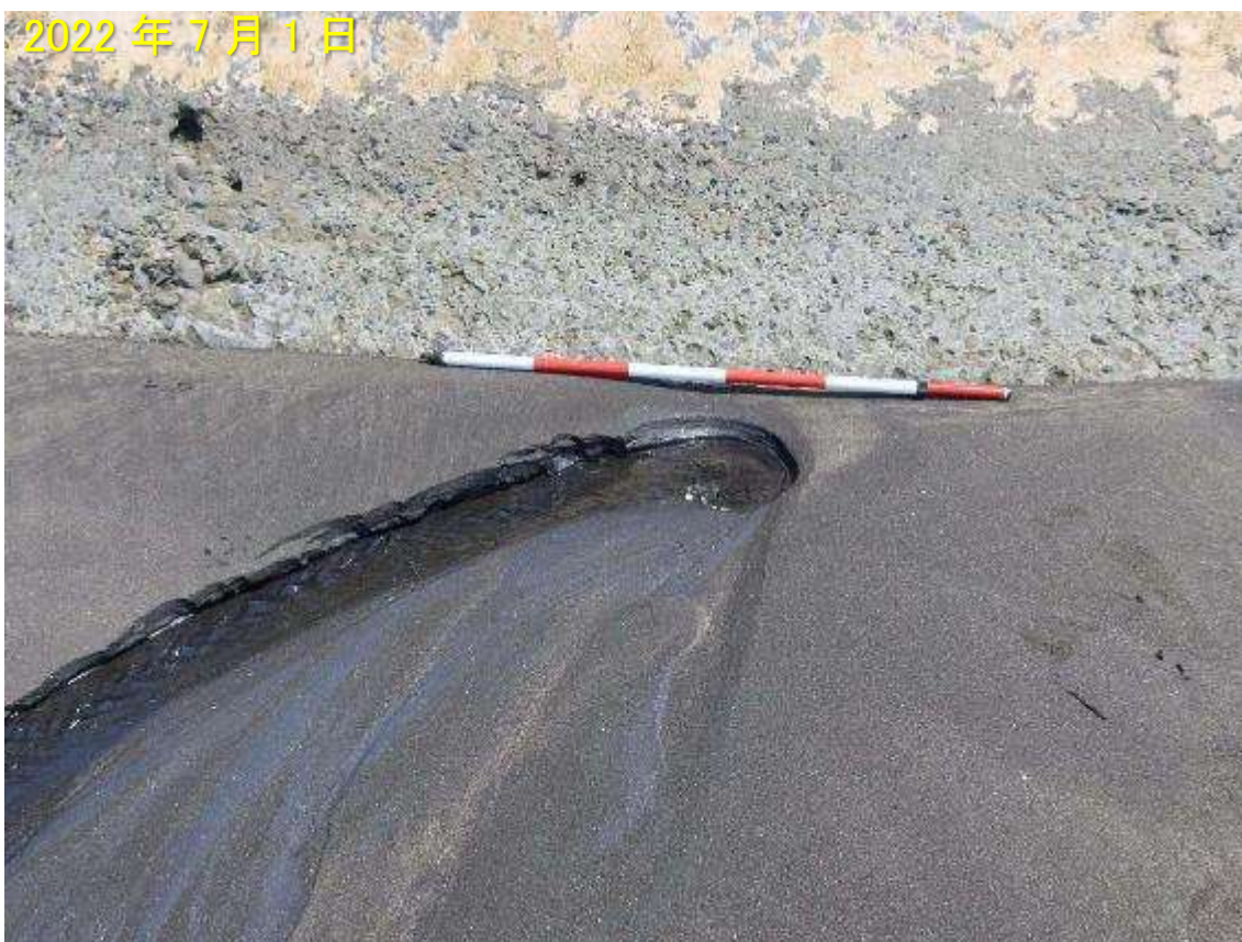
写真-19 護岸凹部で観察された地下水の噴出
