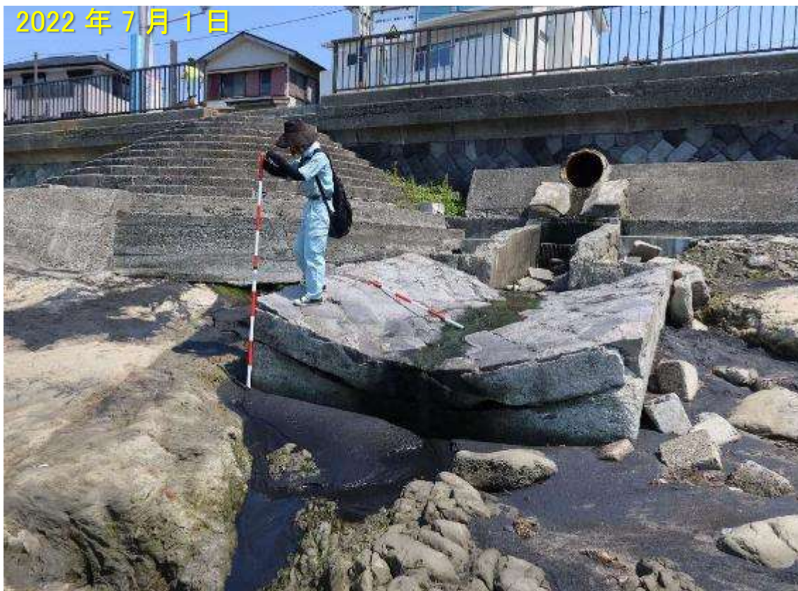
写真-6 侵食により露出した排水管と海側の水叩き 水叩きの西端での海浜地盤上の高さは0.7 m.
