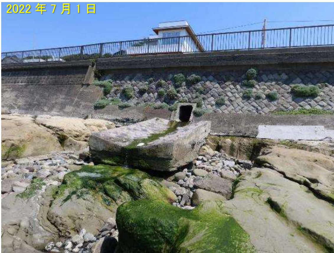
写真-14a 侵食により孤立して残された排水管とその先の水叩き
