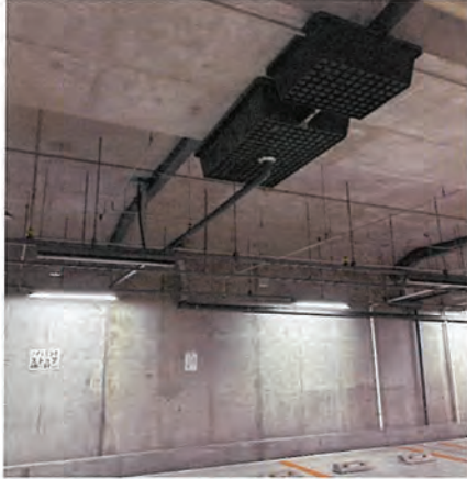
漏水(天井)対策
