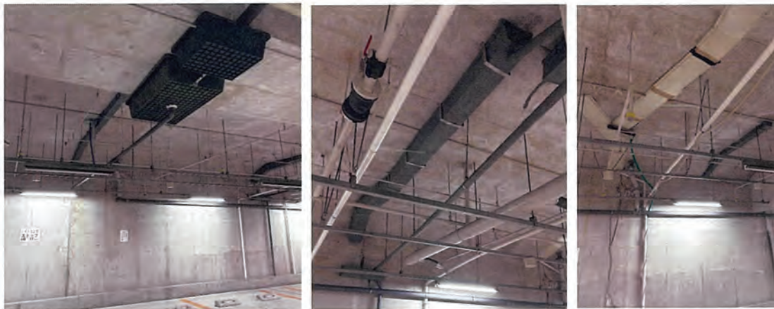
漏水(天井)対策
