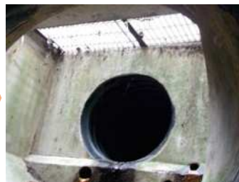
側溝下の雨水管に繋がる管
