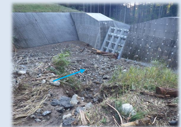
土石流の捕捉状況③
