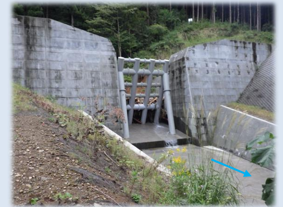
土石流の捕捉状況①
