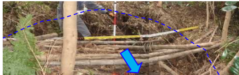
写真② 雨水の流下による斜面の侵食
