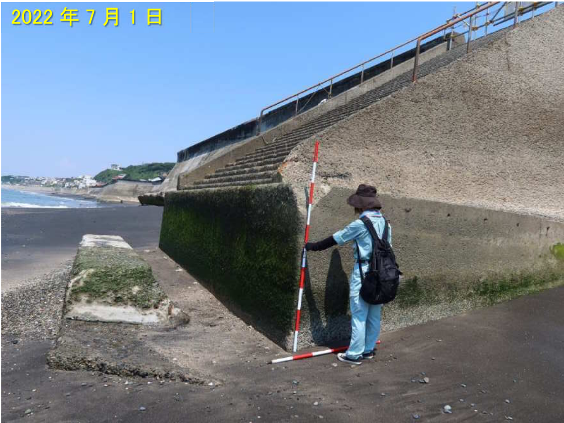
写真-18 駐車場から海浜への階段の先に生じていた比高1.8 mの落差
