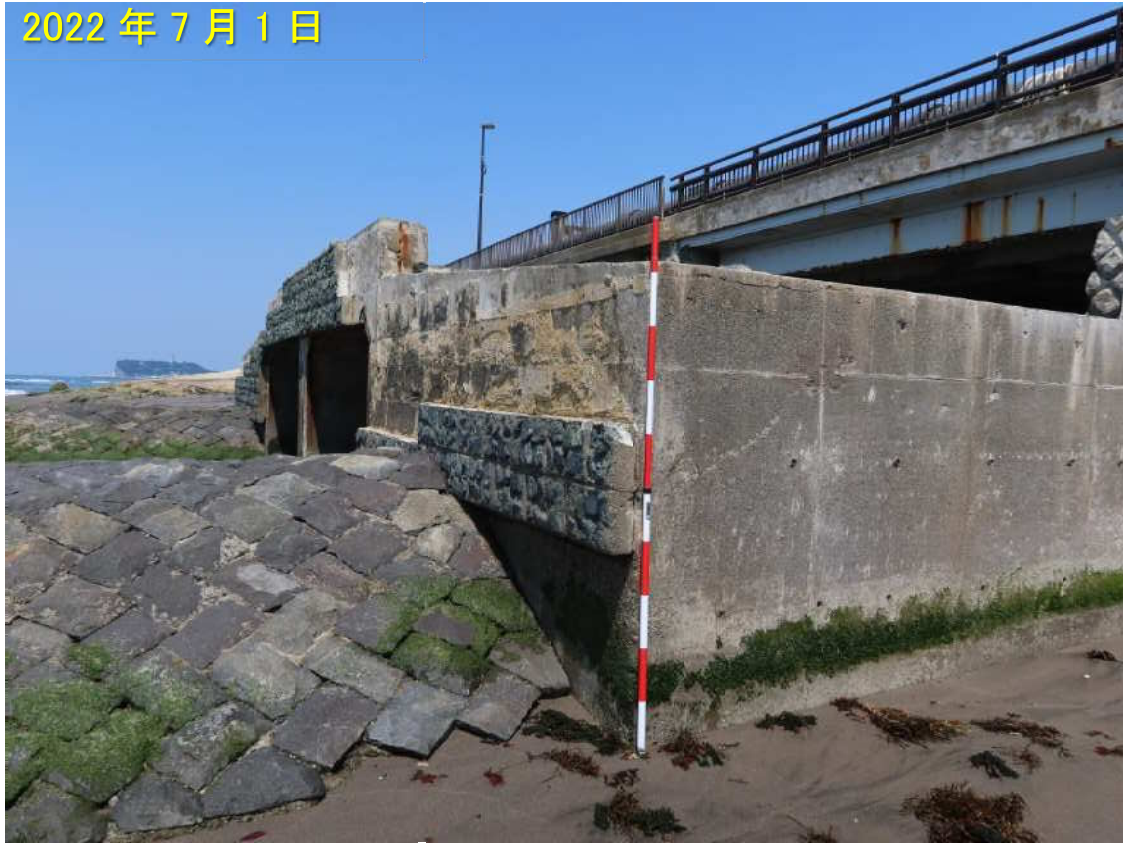
写真-9 音無川の河口に架かる橋の橋台の露出 海浜地盤から橋台の天端までの標高差は1.8 mである。
