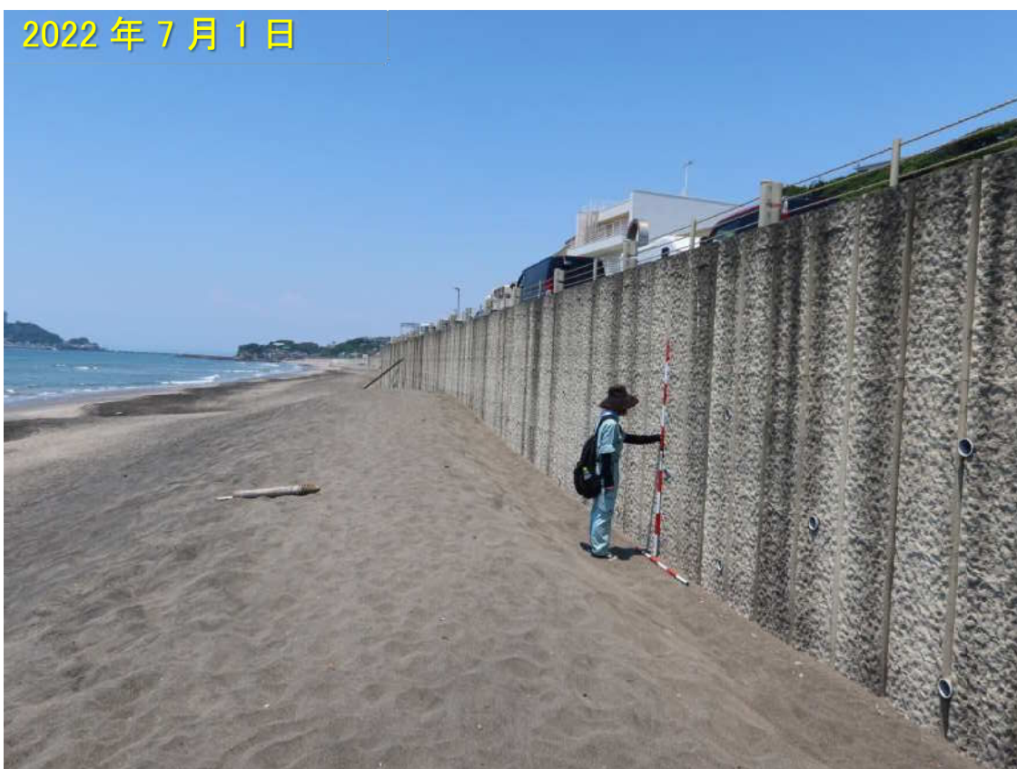
写真-21 修復された直立護岸の前面に飛砂が堆積して形成された砂丘
