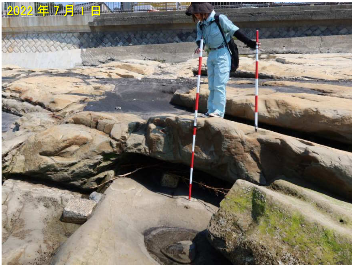
写真-7 侵食されて露出した軟岩層 砂岩と泥岩の互層が現れ、強度の小さい軟岩層が選択的に侵食されている。
