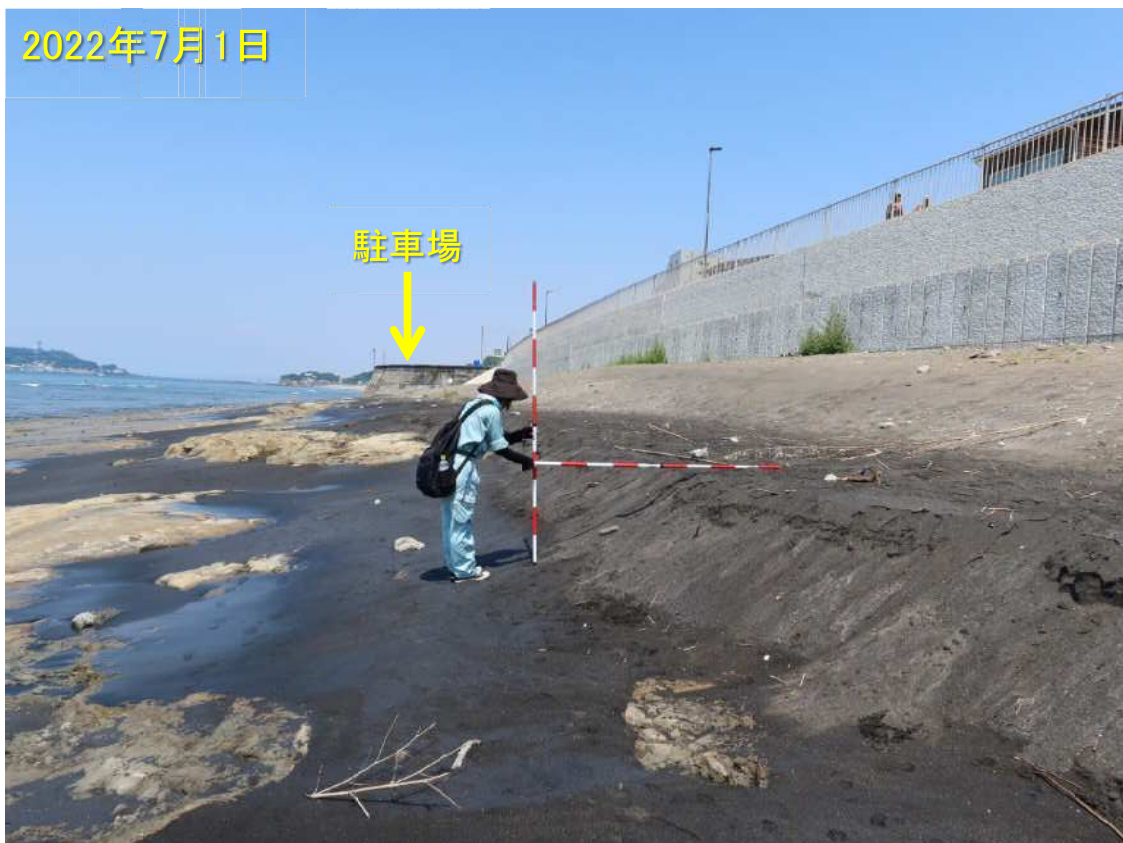
写真-15a 修復された護岸と整地された護岸基部の砂浜で進む侵食（2022年7月1日） 浜崖の比高は0.7 mである。
