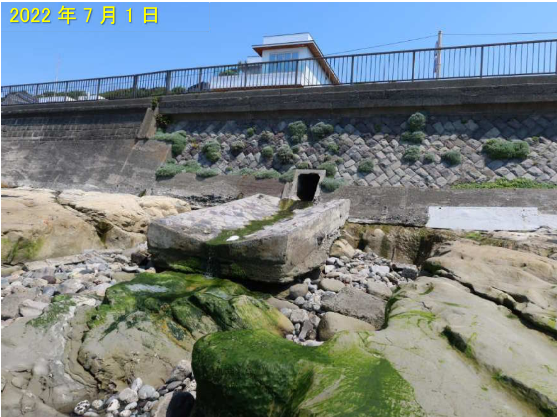
写真-14a 侵食により孤立して残された排水管とその先の水叩き
