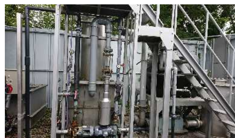
(地下水浄化設備 (秦野市))
