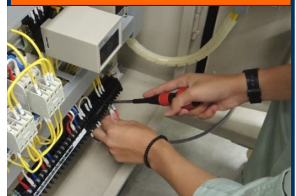
有接点リレーシーケンスやプログラマブルコントローラなどの基礎を習得します。
