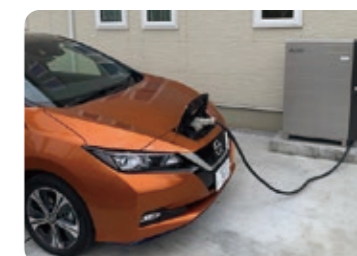
▲V2H充電設備
