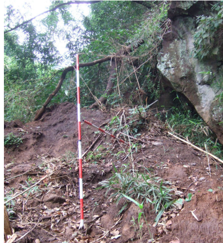
写真① 斜面の崩落状況
