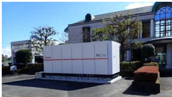
完成した「水素エネルギー供給設備」
