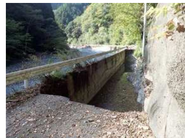
林道の路体流出状況 (県ホームページより)
