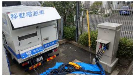
【移動電源車に対応した設備】
