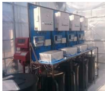
養液タンクの制御装置
