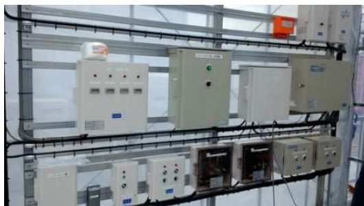
施設栽培における環境制御装置
