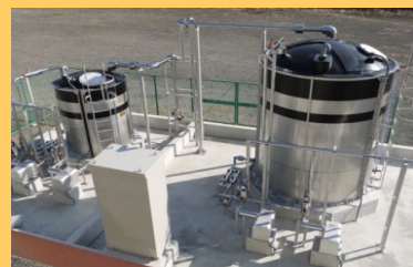
⑨相模川水系上流域対策 山梨県内の下水処理場に設置したリンを取り除くための設備を稼動した。(山梨県桂川清流センター)
