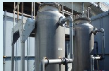
⑦地下水保全対策 有機塩素系化学物質で汚染された地下水を施設の装置に通すことにより水質浄化を図った。(秦野市)
