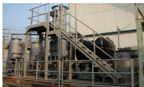
地下水浄化設備(秦野市)
