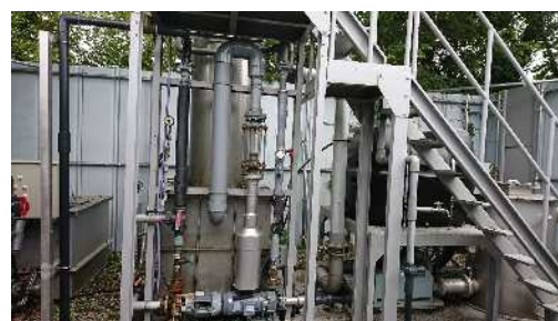
(地下水浄化設備 (秦野市))
