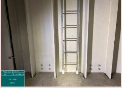
補強前の状況(P2主塔内部)
