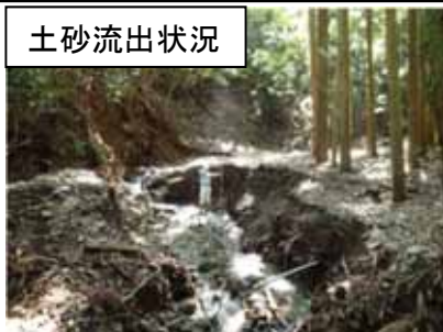
溪岸侵食状況
