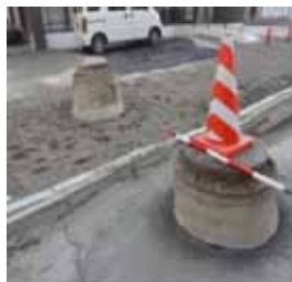
液状化被害写真（マンホール浮上）
