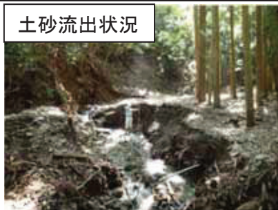
溪岸侵食状況
