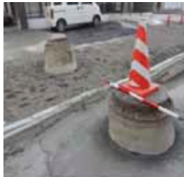
液状化被害写真（マンホール浮上） 出典：下水道管路施設における耐震化技術の有効性 国土交通省資料
