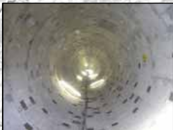
【横浜市】大岡川右岸雨水幹線
