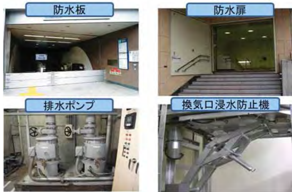
対象となる浸水防止用設備
