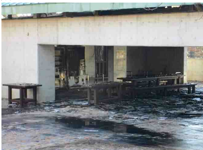
火災後の状況（風のテラス）
