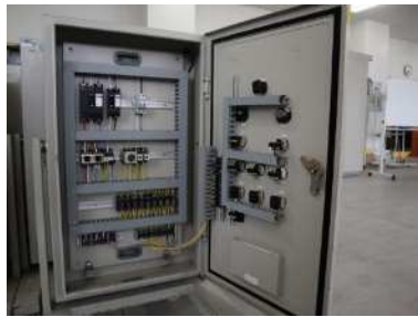
制御盤配線実習
