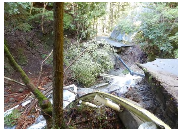
県道70号(秦野清川)27.1kp付近 道路消失
