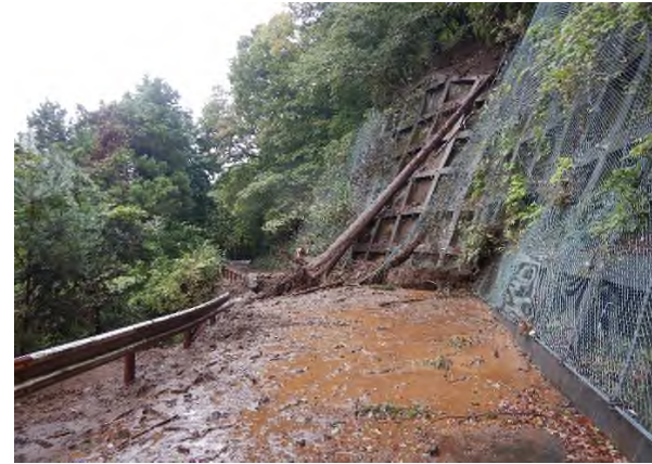
県道70号(秦野清川)26.8kp付近 法面崩落
