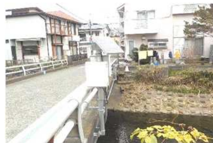
危機管理型水位計、 簡易型河川監視カメラの設置
