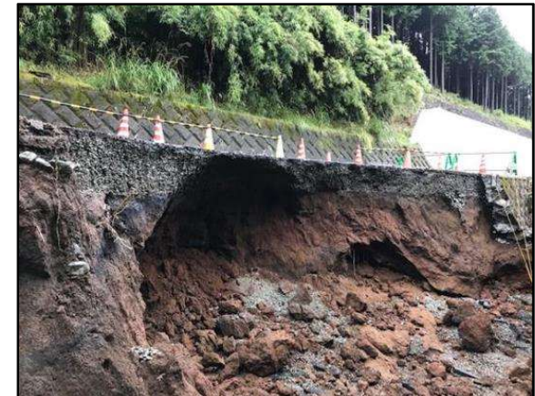
南箱道路 No283付近 路体崩壊
