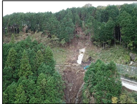
南箱道路 No158付近 法面崩落
