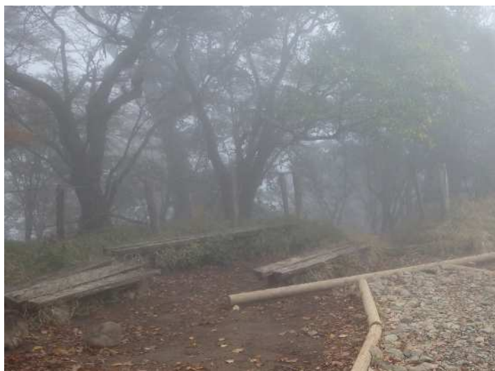
老朽化していたベンチ（平成 28 年 10 月撮影）
