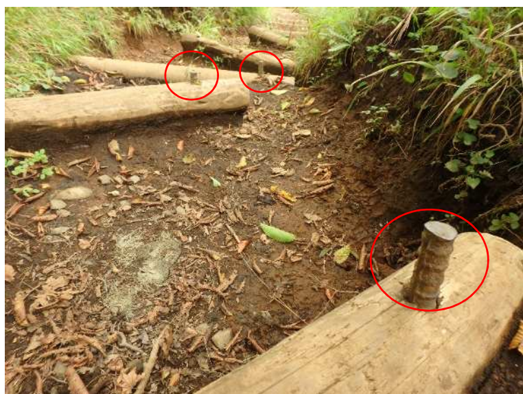
飛び出した鉄杭
