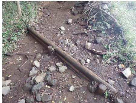
作業前 土砂で埋まった状態
