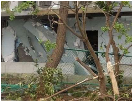
【被災した金沢臨海部産業団地（横浜市）】
