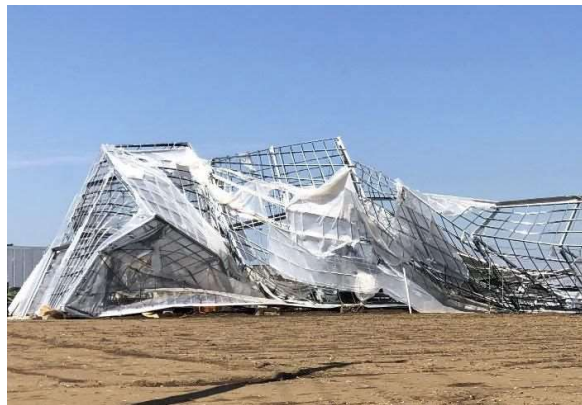
【破損した農業用ハウス（三浦市）】
