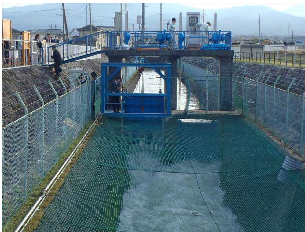
図-6.4 水車下流側の水脈の乱れ
