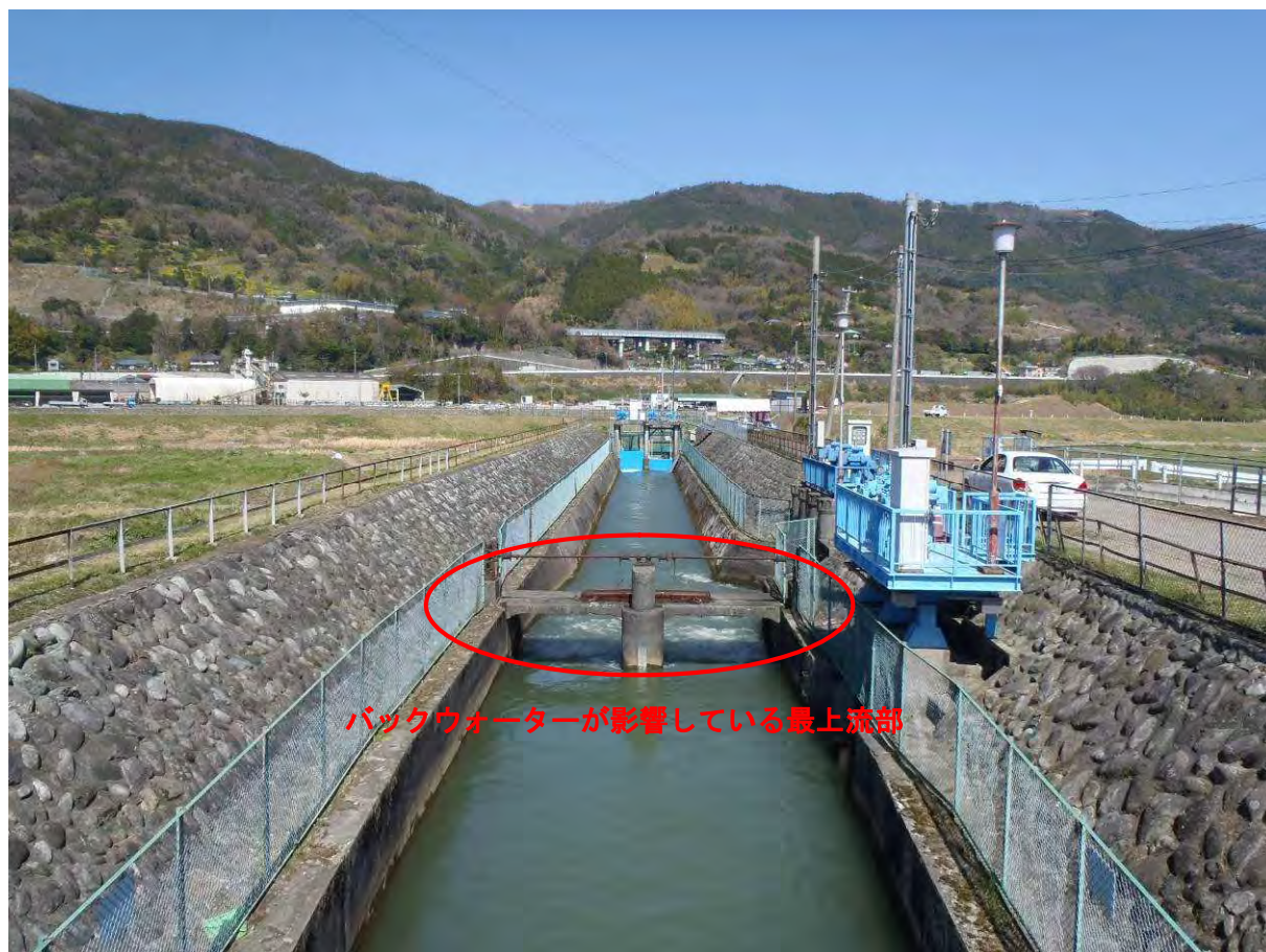
図-6.7 バックウォーターの上流部への影響状況
