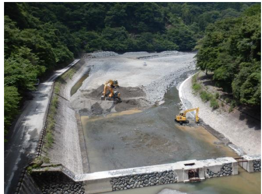
三保貯水池のしゅんせつ作業 (バックホウによる貯砂ダム内の掘削作業)
