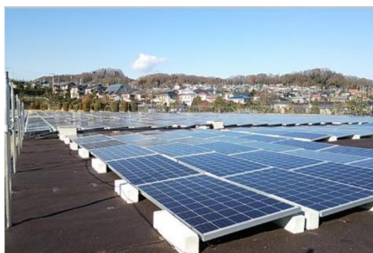
谷ヶ原太陽光発電所 (神奈川県企業庁設置)
