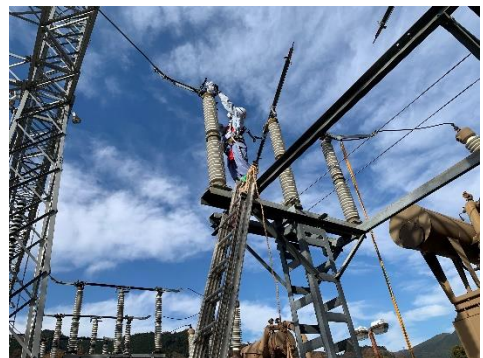
屋外開閉所* 点検の様子
