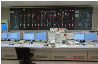
集中監視制御装置
