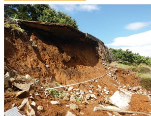
崩落した農道
