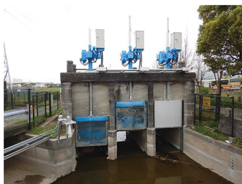
遠隔整備された水門
