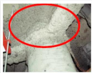
吹付け石綿 (レベル1)
