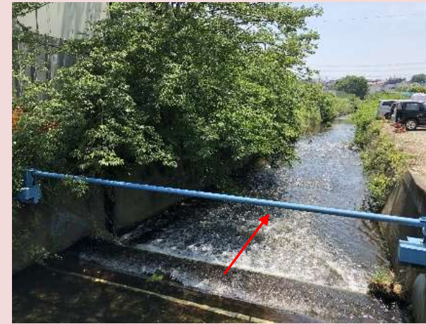
改修前の状況（打越橋下流）
