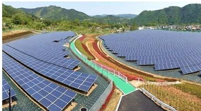
【愛川太陽光発電所】
