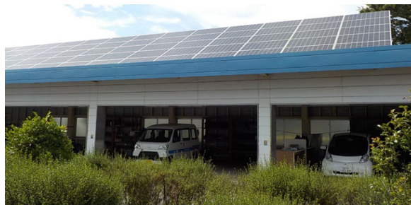
太陽光発電設備 (相模原水道営業所)
