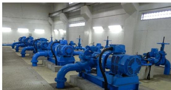
ポンプ設備 (及川ポンプ所)
