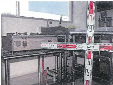
ガスレンジ/厨房浸水 (770 m/m)
