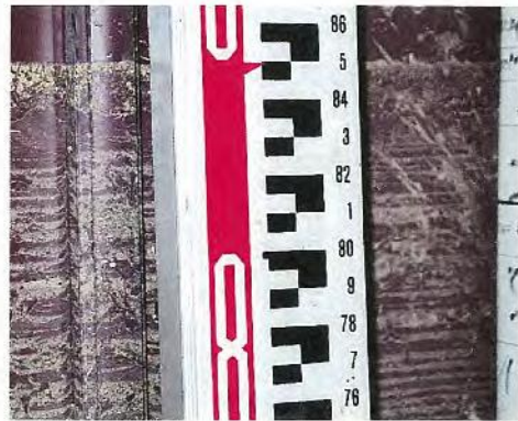
体育館内浸水状況 (接写) (850 mm)
