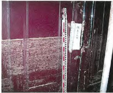
体育館内浸水状況 (850 mm)
