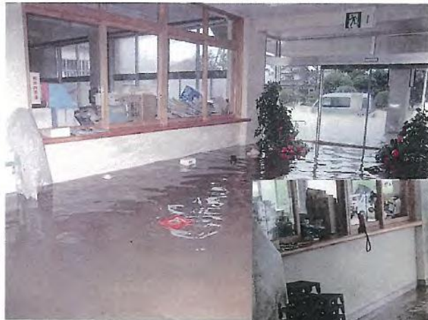
浸水状況（玄関）
