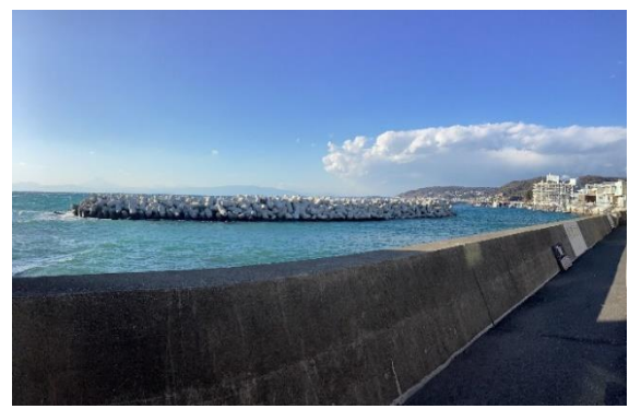
離岸堤（横須賀市営佐島漁港）
