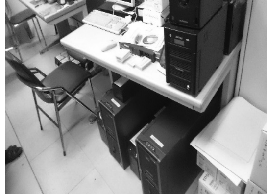
写真7 データベースを保持しているサーバーールーム内のサーバーの状況
