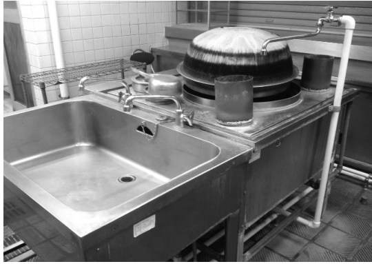
写真16 そば釜と流し台
