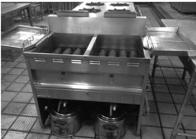
写真12 ガスフライヤー
