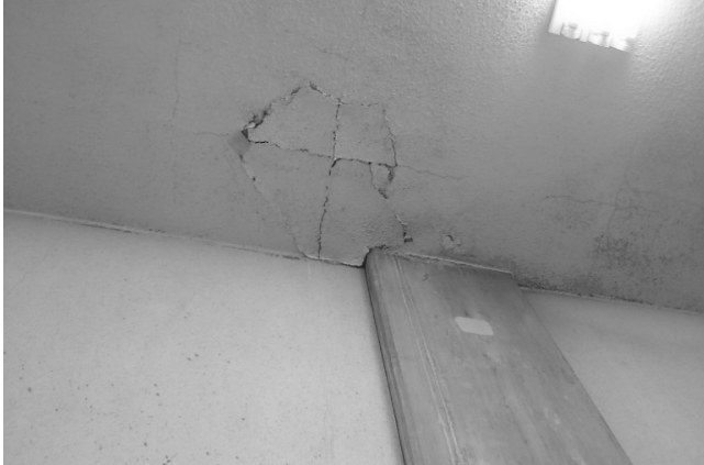
写真3 3階科学技術室天井
