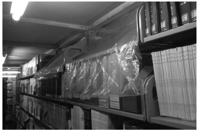
写真6 4階書庫の天井と書籍の状況
