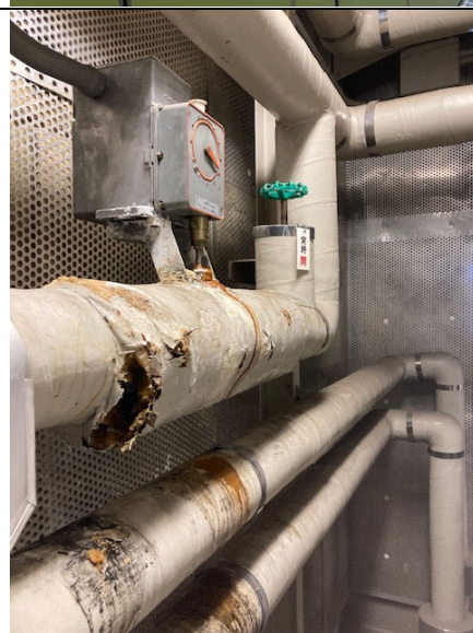
実習棟 2階 (空調機械室)
