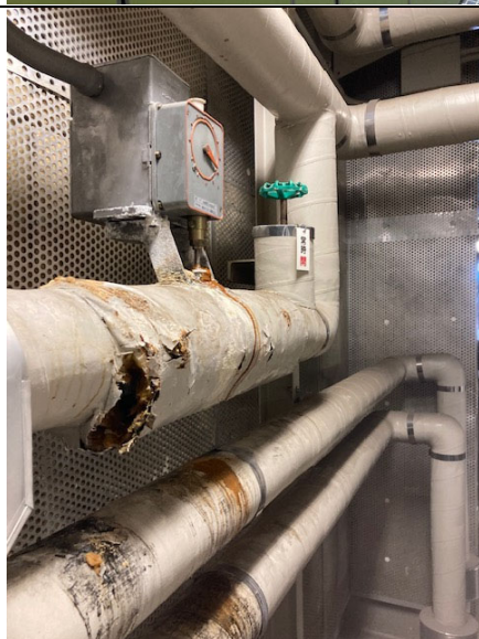
実習棟 2階 (空調機械室)
