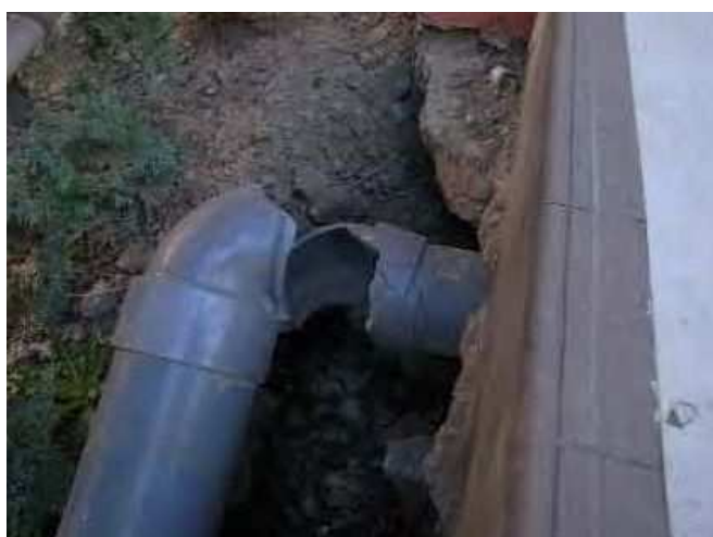
排水管の破断 (平成 23 年度浦安市液状化対策技術検討調査報告書より)
