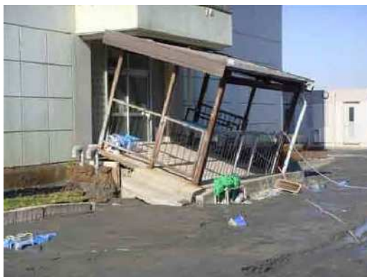
ポーチの沈下(平成 23 年度浦安市液状化対策技術検討調査報告書より)
