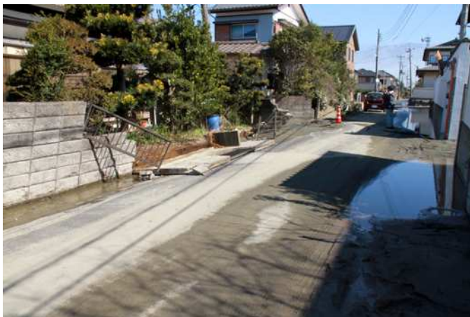
ブロック塀の倒壊（千葉県香取市ホームページより）
