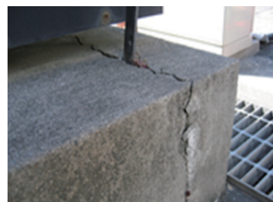
看板基礎のひび割れ
