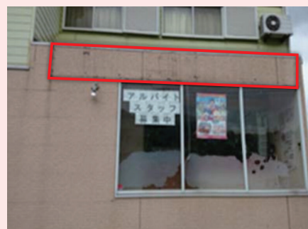
落下した後の壁面
