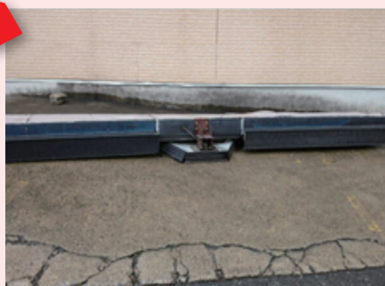
落下した欄間看板
