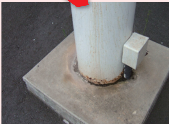
ポールの根元にサビが発生
